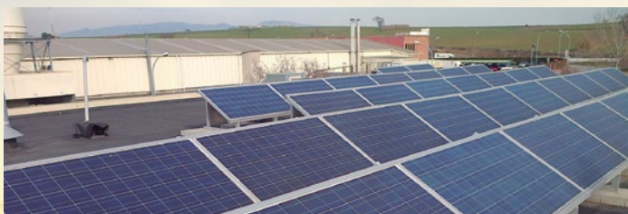
Instalaciones en ámbito industrial o sector terciario
